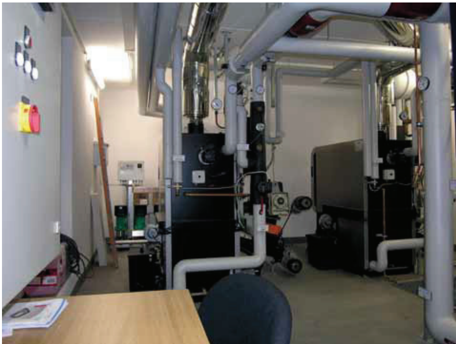
Es gibt Anlagen, die ihr Versprechen bei weitem nicht erfüllen. Das Anlagenmonitoring soll diese identifizieren, wenn z. B. Solarthermie läuft, ohne dass die Erträge stimmen
